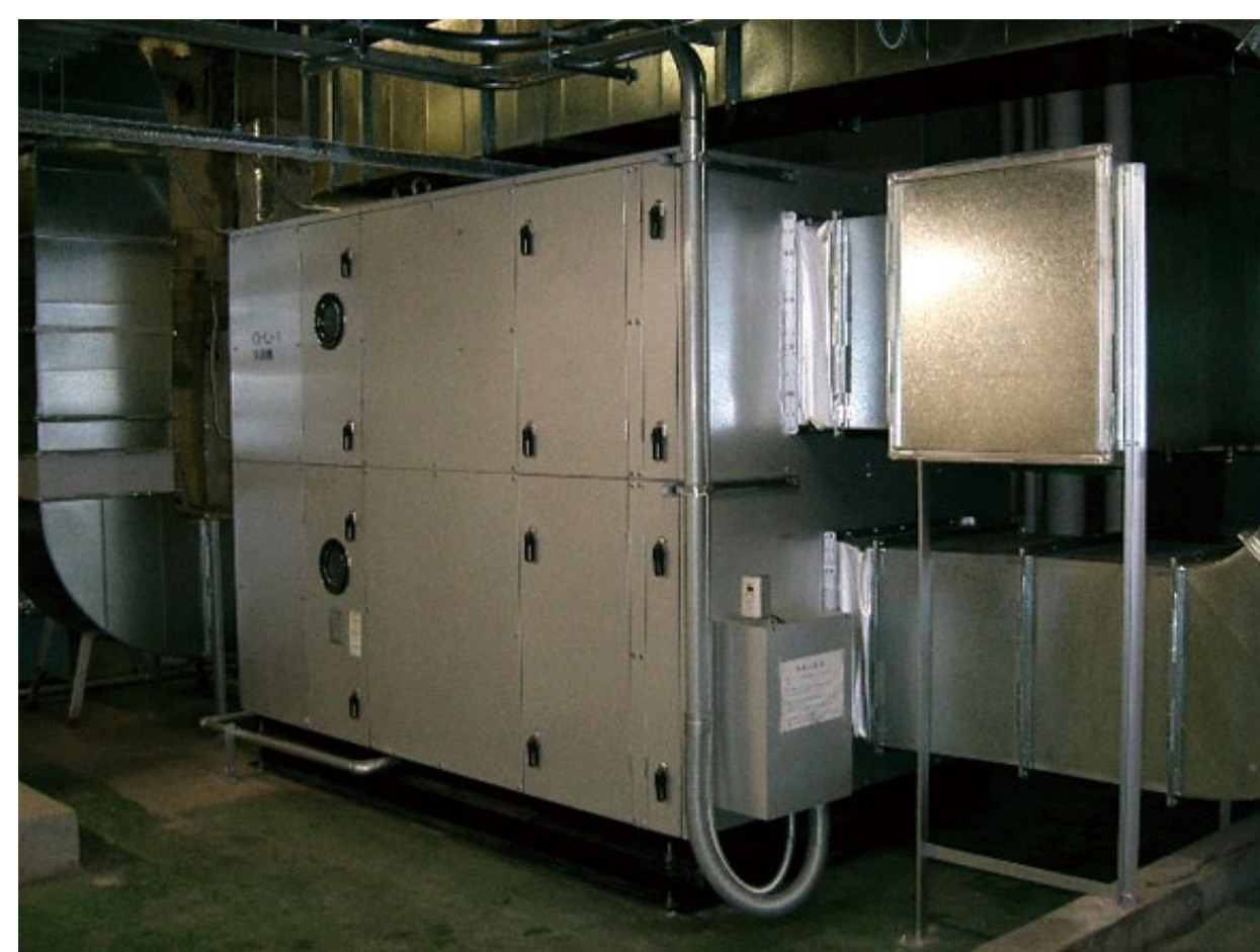
排熱回収型の外調機、高効率照明器具、トイレの人感センサーの制御、誘導灯の高効率化、高効率トランスを採用。
