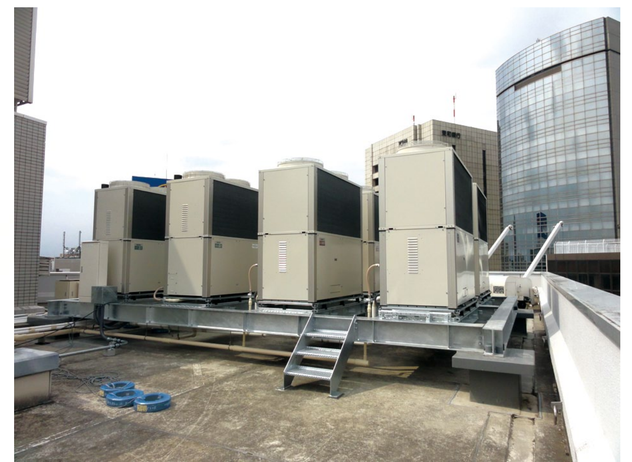
都市ガス焚吸収式冷温水発生器から高効率のガスヒートポンプエアコンへ改修
