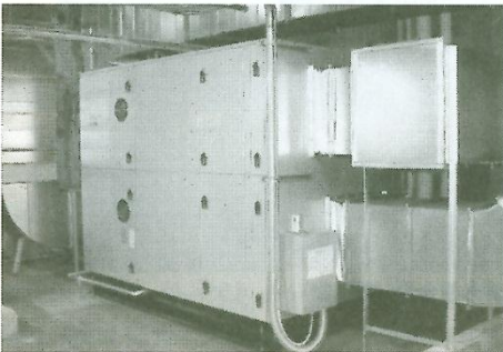
図6 熱回収ヒートポンプ外調機
