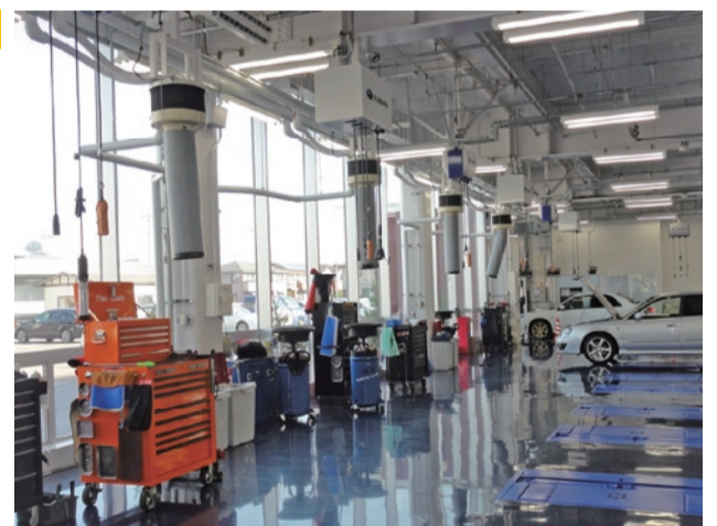
個別にオン、オフできるファンコイルユニットの採用し、工場内の作業環境の改善を図りました。
